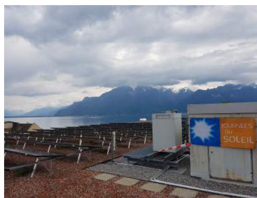
Installation présentée par la Ville de Vevey (VD) sur le toit d'un bâtiment communal alliant photovoltaïque et végétalisation
