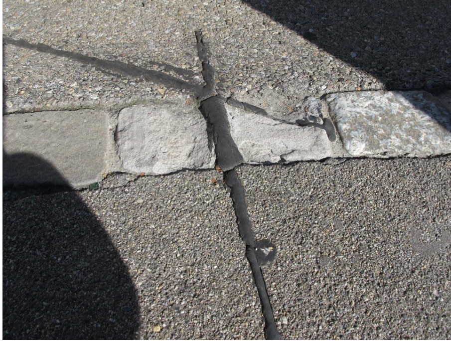
Bild 18: Querung Holderplatz, Winterthur: Belagsschäden können zu Stolperfallen werden
