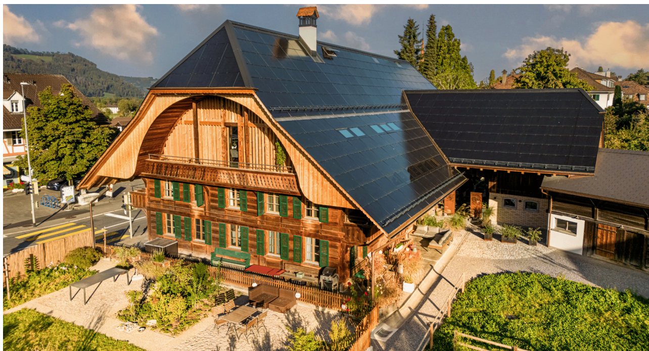
Die Solaranlage auf dem Dach des denkmalgeschützten Bauernhauses produziert mehr Strom als die Bewohnerinnen und Bewohner verbrauchen 11 .
