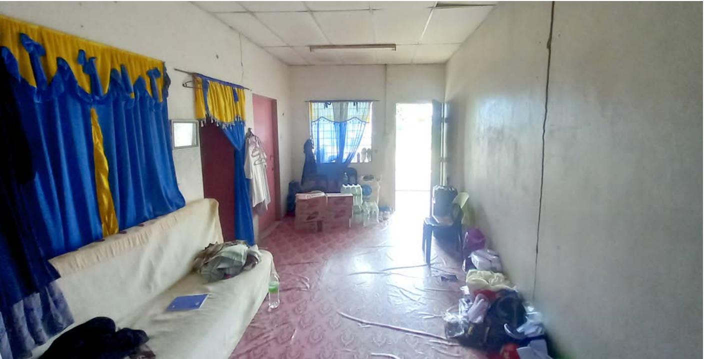
Abb. 5: Wohnzimmer einer Wohnung auf der «Suluk»-Plantage. Die Wand rechts hat einen grossen Riss.
